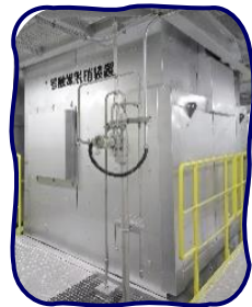
触媒脱硝装置
