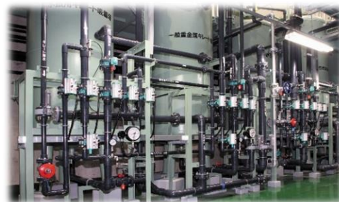
浸出水処理施設
