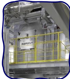
溶融炉減温塔
